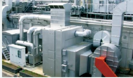
浓缩燃烧 VOC设备
